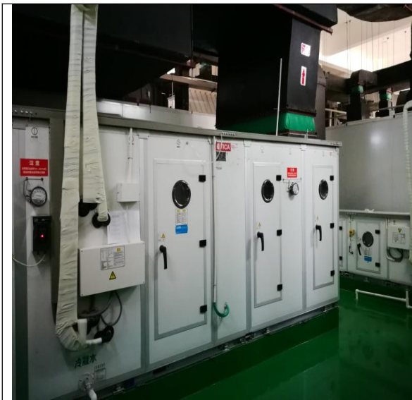
净化空调通风系统
